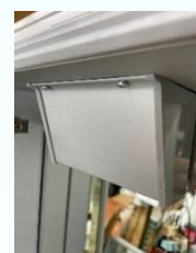
CAJA DE CONEXIONES
