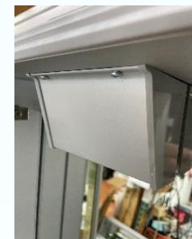
CAJA DE CONEXIONES
