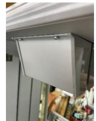
Caja de conexiones
