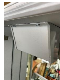
CAJA DE CONEXIONES
