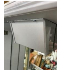
CAJA DE CONEXIONES
