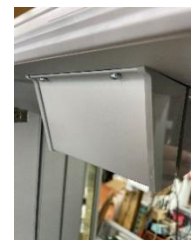
CAJA DE CONEXIONES
