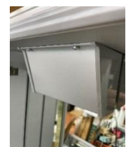
CAJA DE CONEXIONES
