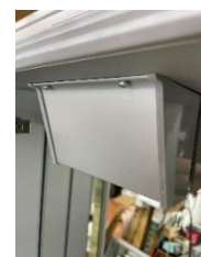
CAJA DE CONEXIONES
