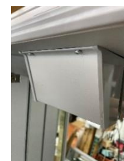
CAJA DE CONEXIONES
