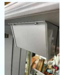
CAJA DE CONEXIONES
