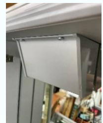
CAJA DE CONEXIONES
