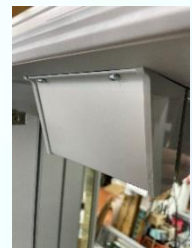
CAJA DE CONEXIONES
